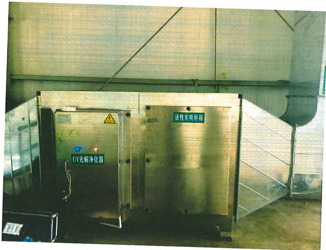
图 4.1-3 喷漆废气处理装置现场照片
